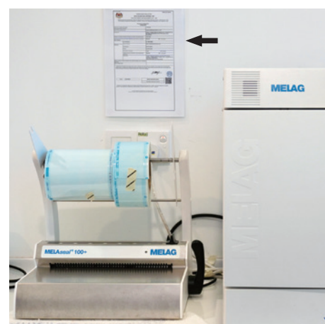
ステリライゼーションルームに設置されているバキューレーブ41B+ (日本未発売製品 日本で発売されている31B+と同型機種) クラスBステリライザーのすぐ横に保険省のサティフィケート(矢印)が提示されている。
